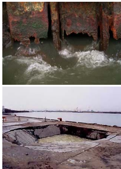
図-1 損傷した鋼矢板岸壁（上）と内部の空洞化により陥没した岸壁（下）
