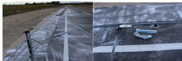
写真 3 衝突後の状況（左）と破断した支柱（右）
