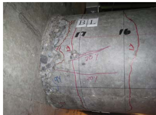
写真-3.6 縦方向のクラックの発生状況 (20 \delta ,時)
