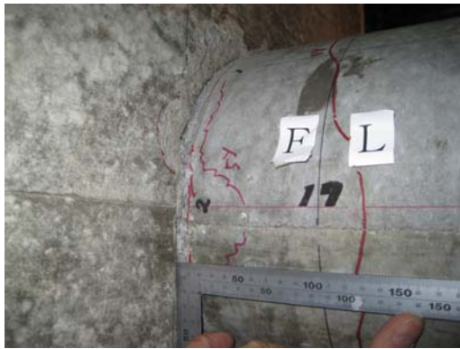
写真-3.3 杭の抜け出しの状況 (-5 \delta ,時)
