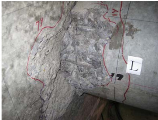
写真-3.4 F杭のスパイラル筋の破断状況 (-8 \delta ,時)
