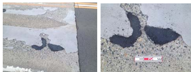
写真 3-2 補修をやり直した事例（路線 F）
