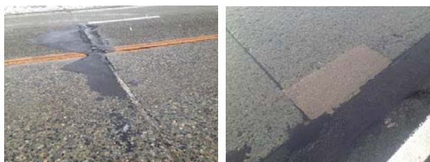
(a) 加熱合材 (b) 超速硬セメント系材料 写真 3-1 角欠けの補修事例（路線 D）
