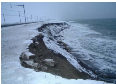
(b) 被災事例2 (B地区)
