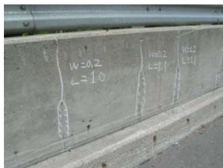
(b) 鉄筋腐食による浮き
