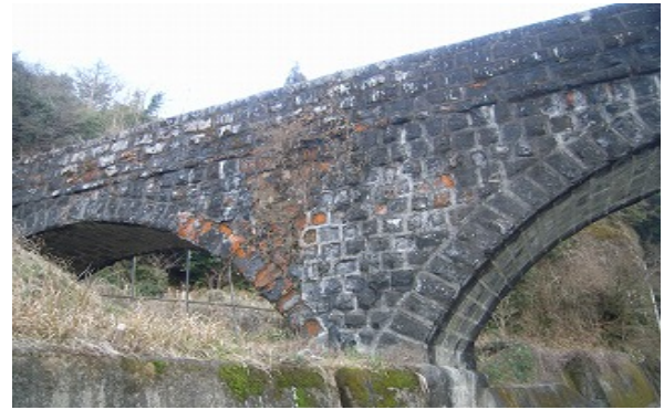
図-4 劣化による表面の剥離
