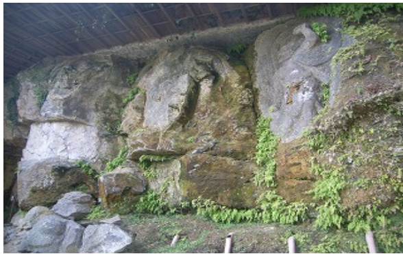
図-3 石仏下部の劣化状況
