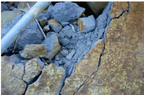
図-7 劣化して砂状になった中粒砂岩
