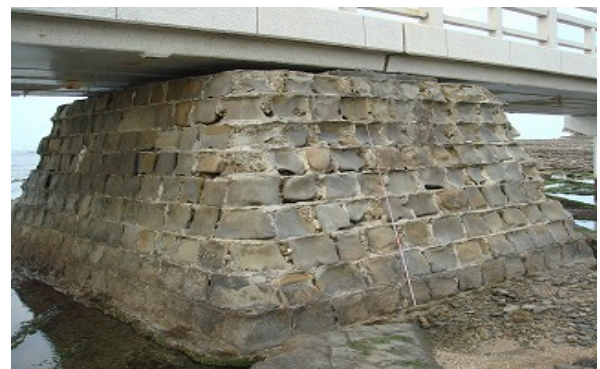
図-5 飛沫帯箇所の劣化
