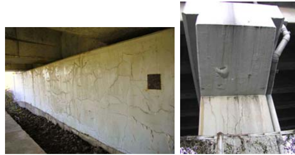
図-2.2.1 表面保護による補修箇所の再劣化事例 4)
