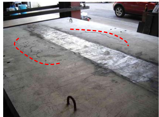
図-14 供試体 NS1 上面の陥没状況
