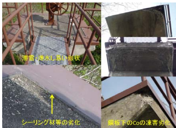
写真-2.3 凍害劣化が生じ易い樋門の事例(1)
