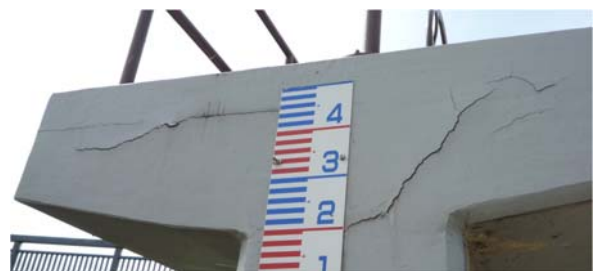
写真-3.1 操作台の再劣化状況
