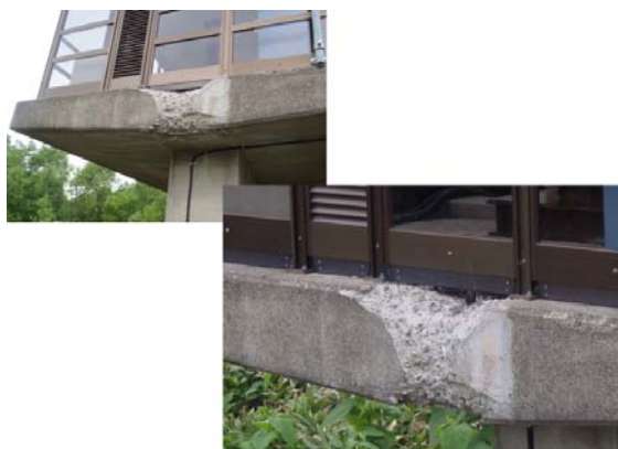
写真-2.4 凍害劣化が生じ易い樋門の事例(2)
