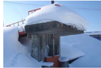
写真-2.2 樋門操作台の滞雪状況
