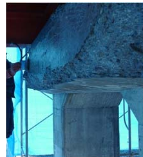
写真-3.4 施工時状況 (除去不足)
