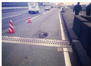
舗装に生じた変状
