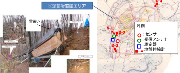
写真3.3.1 無線式距離計測システムの設置状況
