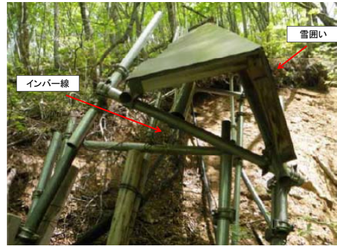
写真3.3.2 地盤伸縮計の状況(東北地方太平洋沖地震後)
