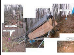
写真4.2.2 無線式距離計測システムの設置状況
