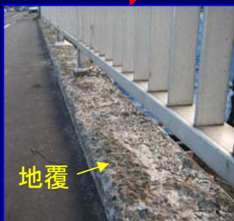
既設橋(供用38年)の地覆 コンクリート劣化状況
