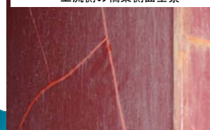
主桁 内面の塗膜われ発生状況
