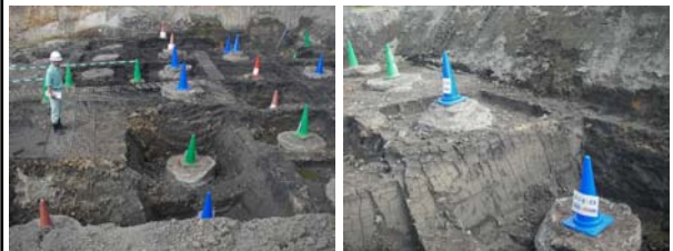
施工不良の例
