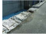
地覆部の圧壊
