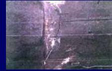
ひび割れと横断目地との 組合せで半月状にブロック化
