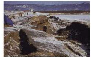
1993年釧路沖地震の河川堤防被害
