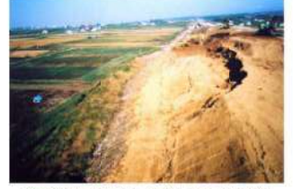
泥炭性軟弱地盤上の盛土のすべり破壊
