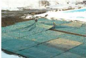
シートによる雪混入防止対策
