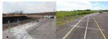
衝突後の防護柵の破損状況(2016年3月, 8月)
