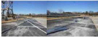
衝突後の防護柵の破損状況(2012年1月)
