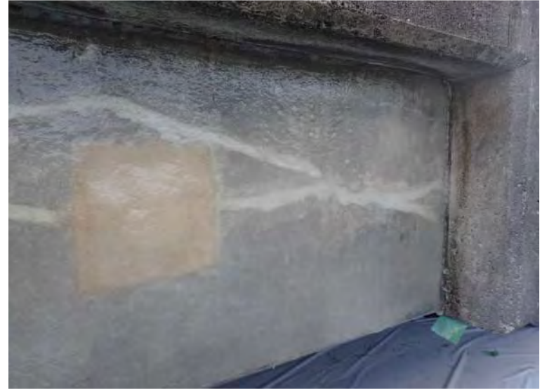
道路橋(補修箇所が多い)
