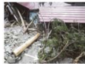
半壊家屋上流側に堆積した土砂
