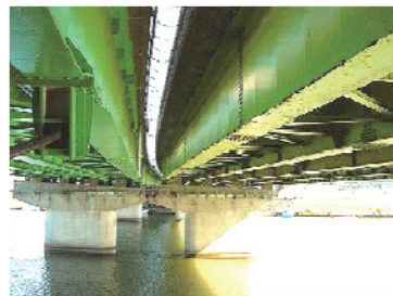
厳しい腐食環境に架かる橋梁
