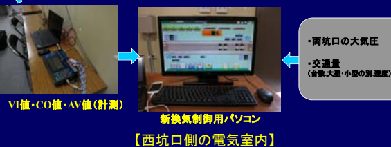
【西坑口側の電気室内】
