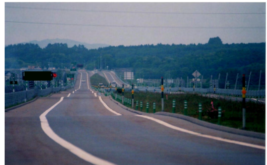
泥炭性軟弱地盤上の道路の不同沈下
