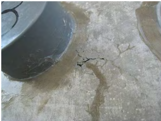
離れた位置から水漏れ
