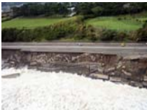
国道1号西湘バイパス (2007.9)
