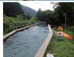
水槽兼沈砂池(運用中)
