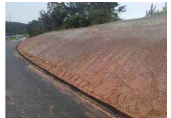
団粒化剤吹付（種子なし）が降雨により流失した様子
