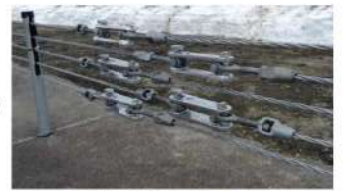
緊急開放金具の設置状況
