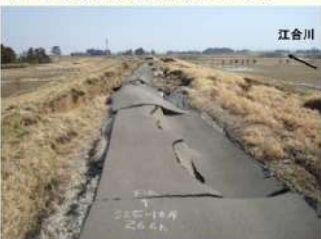
東日本大震災時堤防崩壊(2011/3月)
