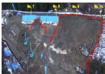
由利本荘市切土斜面崩壊(2013/11月)
