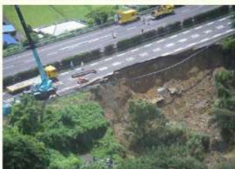
東名牧之原高盛土地震時崩壊(2009/8月)
