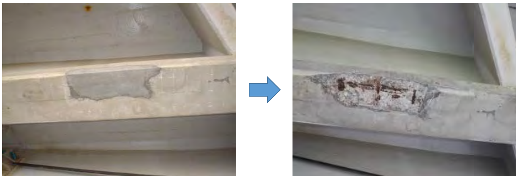
断面修復部のはく落の例
