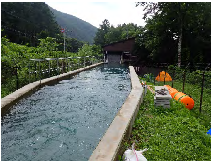
水槽兼沈砂池(運用中)
