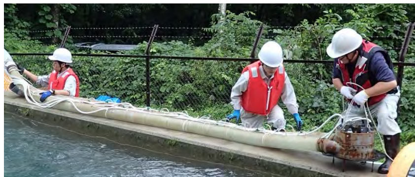
管径100mm潜行吸引式排砂管
