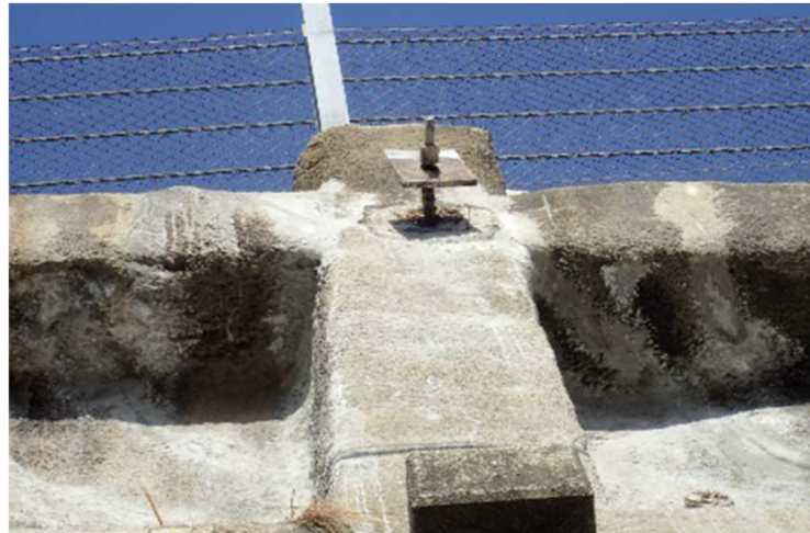
腐食により破断したアンカー
