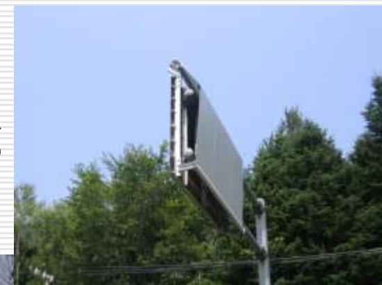
▲ 着雪防止シートの設置事例
