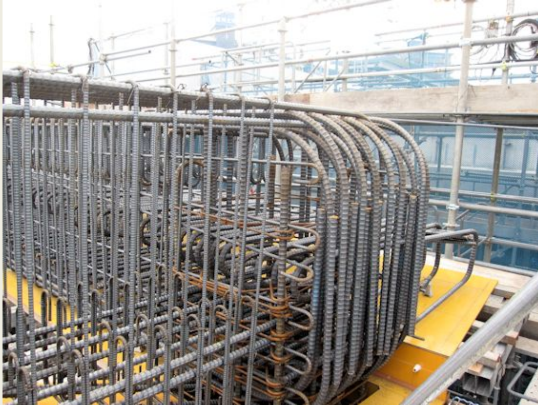
鉄筋が輻輳している例
