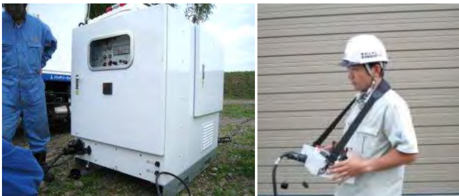
制御盤及びコントローラ
