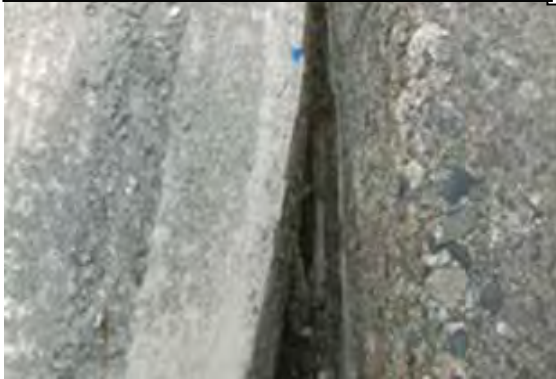
歩道（地覆）端部から浸水
