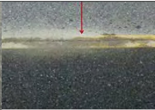
舗装打継ぎ目から浸水
