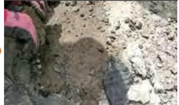
コンクリート床板の土砂化
