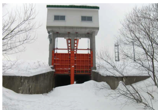
樋門設備全景（冬期間）
