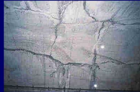
コールドジョイントとひび割れとの組合せでブロック化
