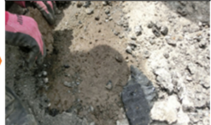
コンクリート床板の土砂化
