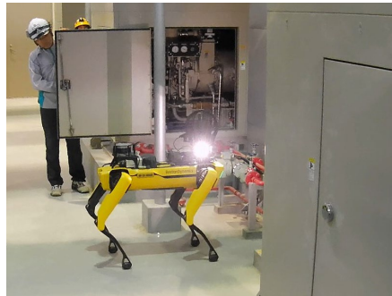
機械設備維持管理支援手法
