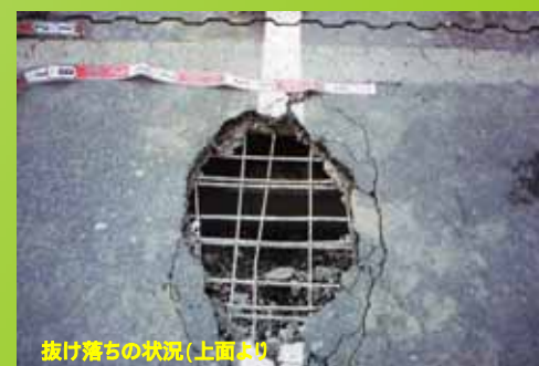
抜け落ち直前の網裂の状況
