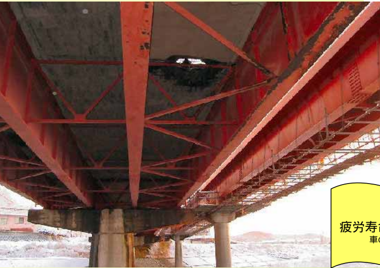
鉄筋コンクリート床版の抜け落ち例
