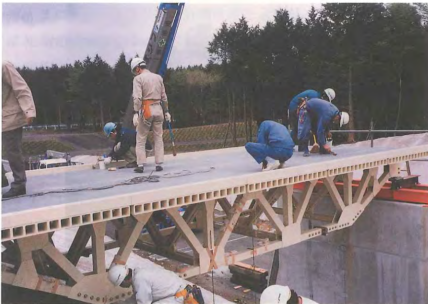
滑り止め板 リベット頭部 塗装
