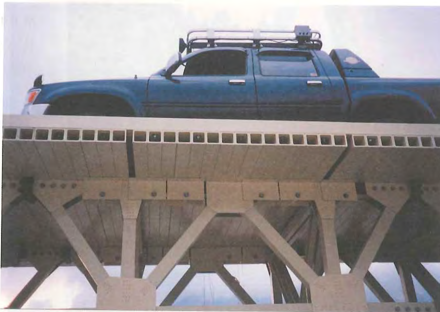
静的載荷試験 床版下面
