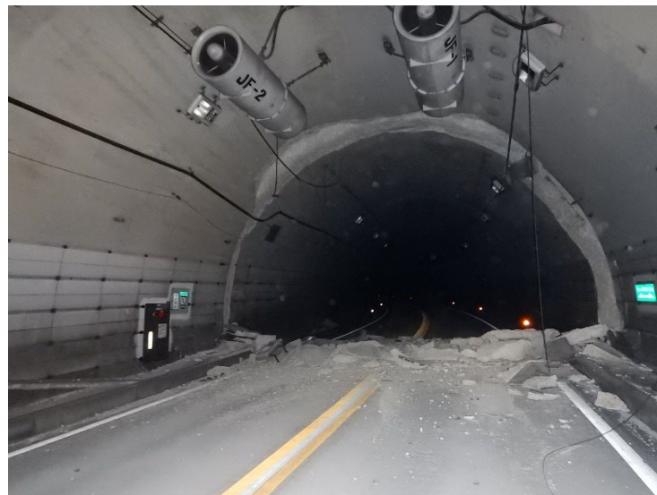
写真 3-4 平成 28 年熊本地震により被害を受けたトンネルの例
