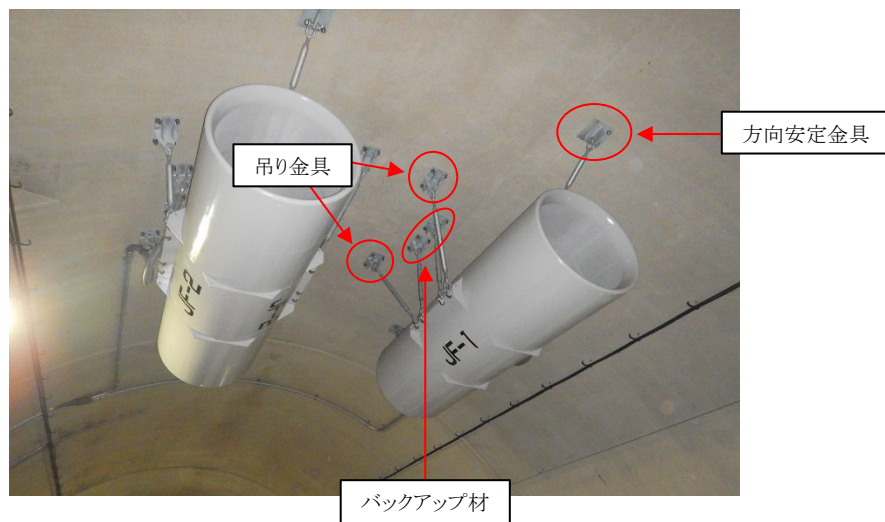
写真3-1 ジェットファンの設置状況の例（バックアップ材付）
