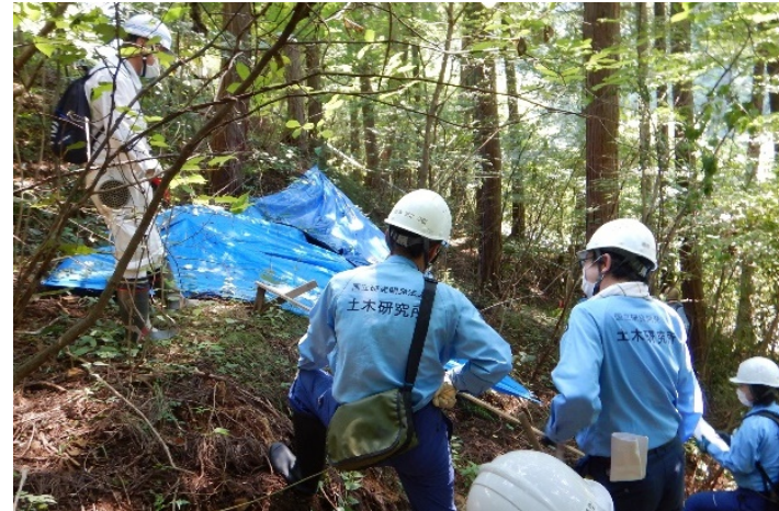
林地内に生じた滑落崖の確認
