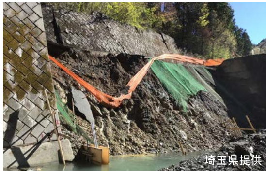
現地の状況 (護岸被災箇所)
