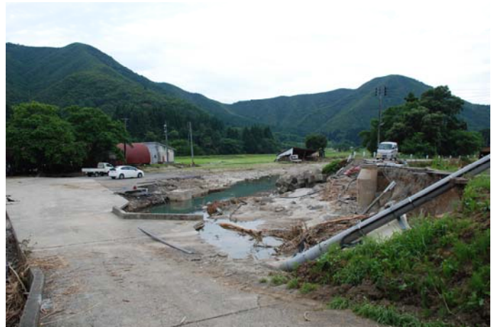
写真-14 流水により欠損した道路と浸水跡
