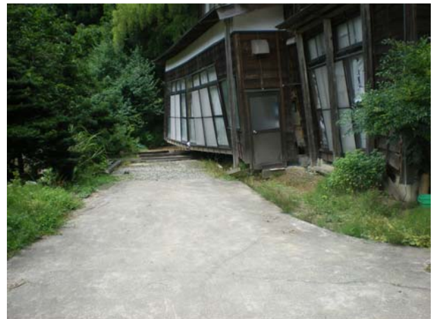
写真-7 民家のゆがみ
