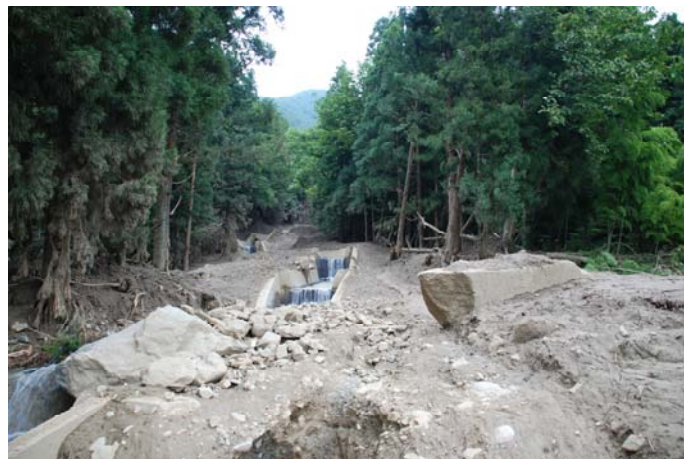
写真-22 小川 既設流路とコンクリート塊（コンクリート塊は横断構造物の袖部と思われる）
