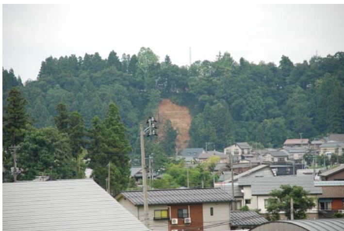
写真-11 崩壊斜面全景
