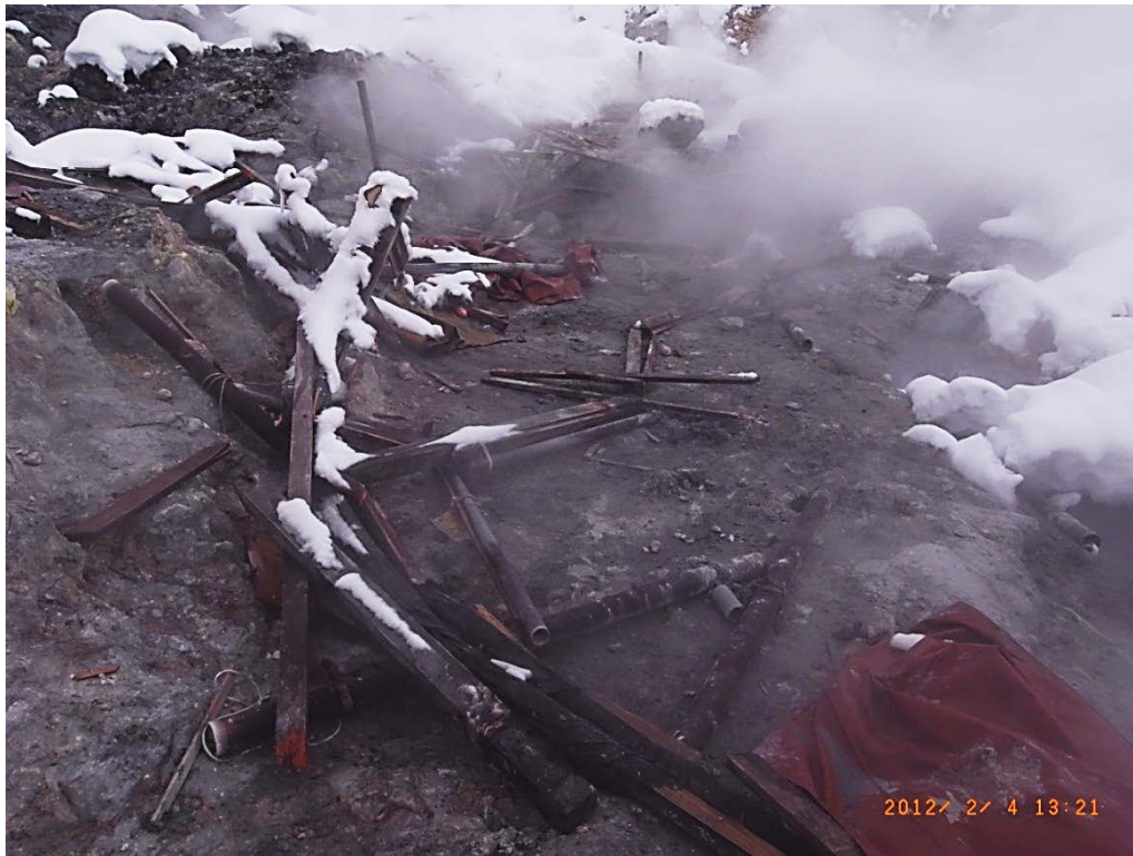
写真 8 被災箇所状況
